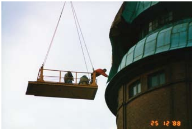
Sturmschaden am Wasserturm Weihnachten 1988
