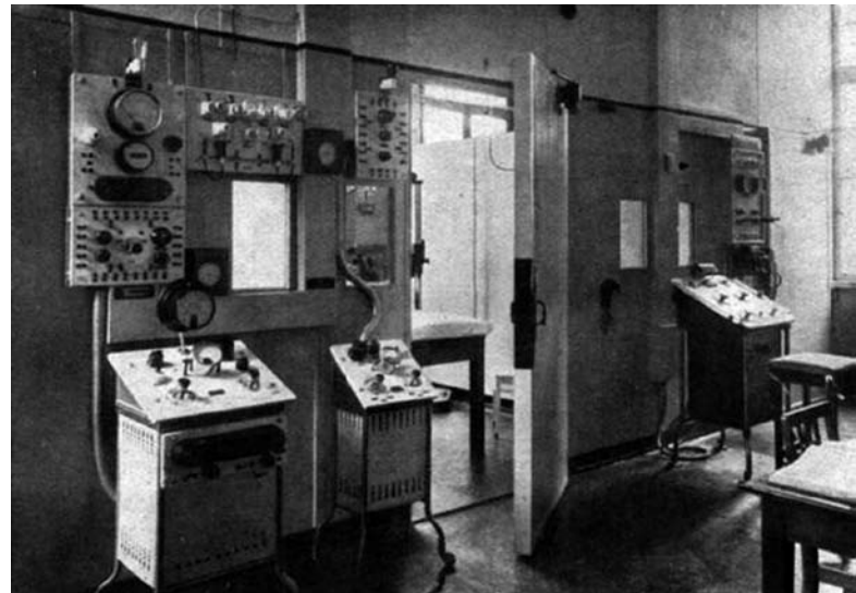
Schutzhaus mit Schalttischen, Mess-Apparaten und Fernregulierungen
